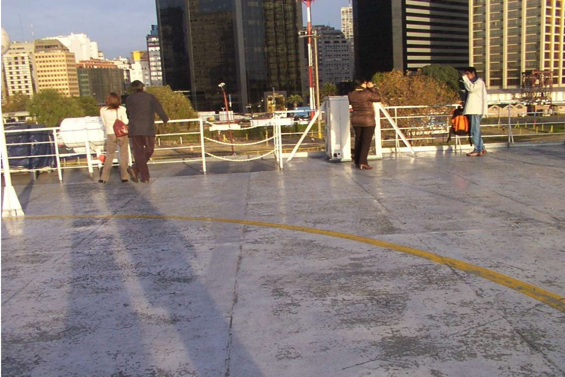
7- Algunos espacios tienen como medida de seguridad cadenas en lugar de baranda.
