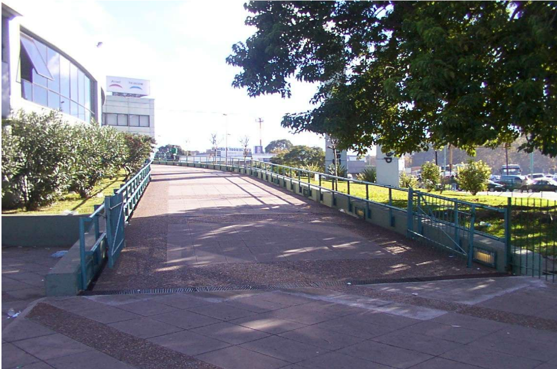
3- En la imagen podemos observar que esta entrada está constituida por una rampa con un ancho superior a 1,30 metros, sin pasamanos intermedio y sin superficies planas de descanso cada 6,00 metros.
