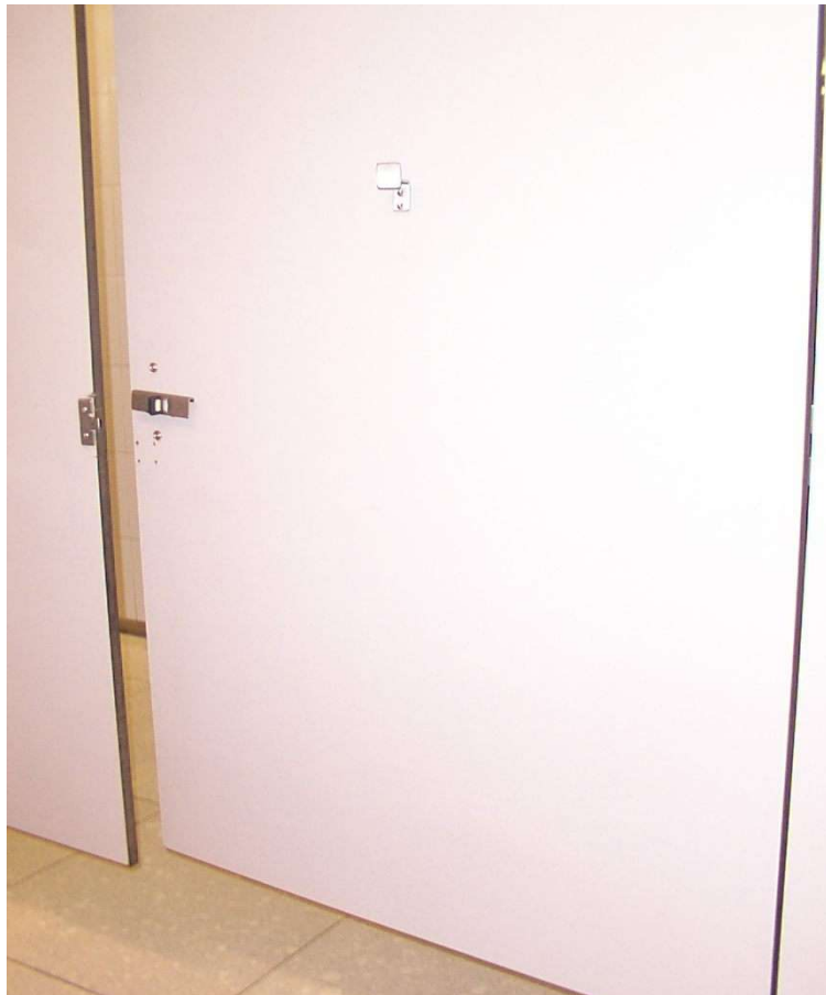
23- Puerta del sanitario accesible: superior a 0,80 metros de ancho, abre hacia afuera. El herraje y el gancho de colgar están a una altura apta para un usuario de silla de ruedas.
