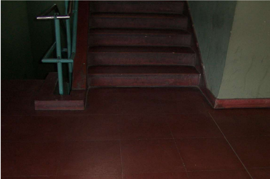
31- Aquí se puede apreciar mejor la falta de solado contrastante y de relieve.
